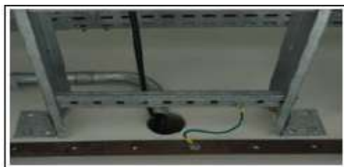
Figura 25 – Aterramento de Leito de Cabos.
