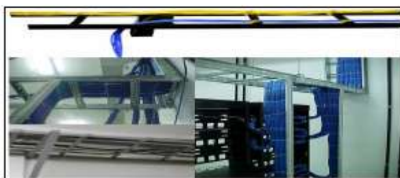
Figura 26 - Instalações com leitos de cabos.
