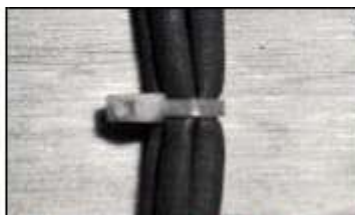
Figura 38 – Método inadequado de fixação de cabos.
