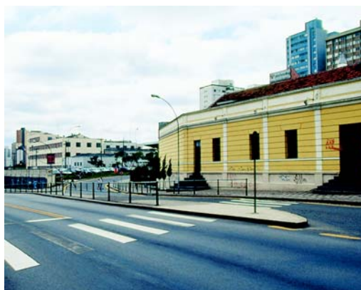
EMPREENDIMENTO: Pollo Shopping Estação, Curitiba / PR SERVIÇOS: Implantação de via para acesso ao estacionamento; colocação de grades para proteção do pedestre
