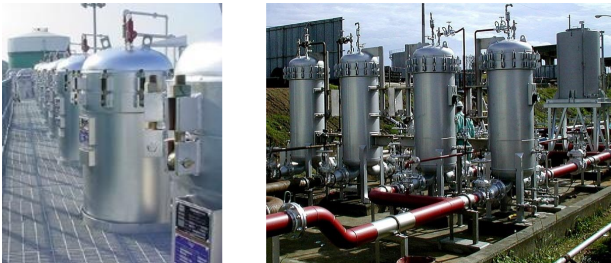
Figura 15 – Os filtros separadores devem ser enquadrados
