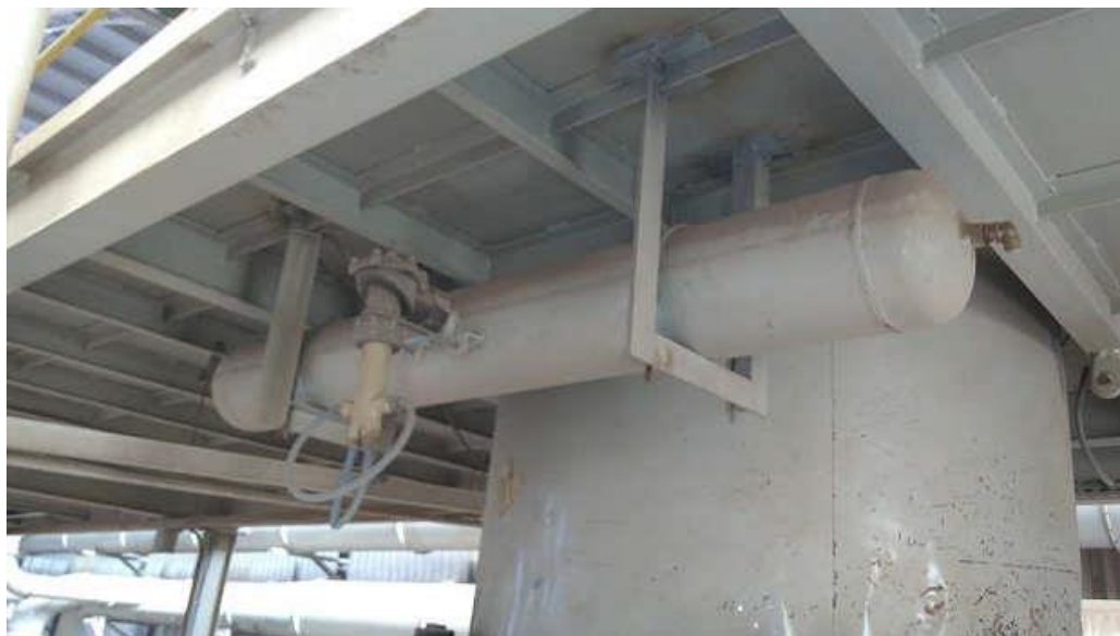
Figura 20 – Exemplo de componente de tubulação
