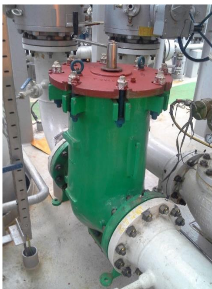
Figura 14 – Filtro suportado pela tubulação
