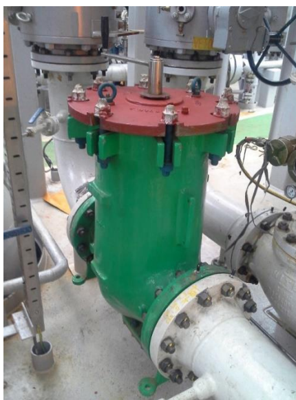
Figura 14 – Filtro suportado pela tubulação
