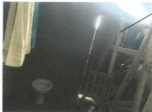
Banheiro, sem água, e louça de vaso sanitário, não instalado. Local utilizado como depósito.
