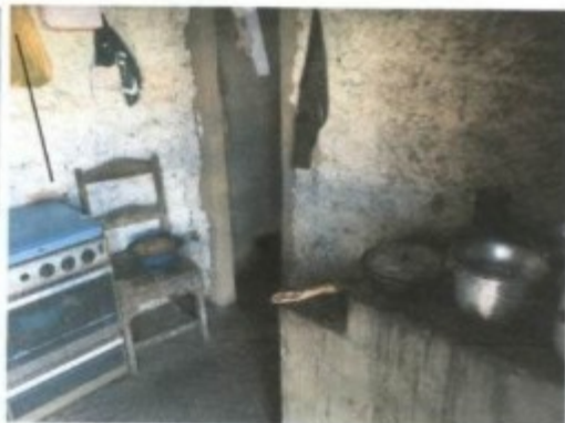
Cozinha do Alojamento com fogão que "nunca" funcionou (SIC)
