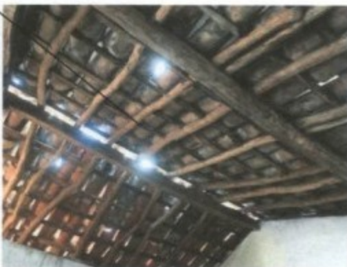
Aberturas no telhado do alojamento
