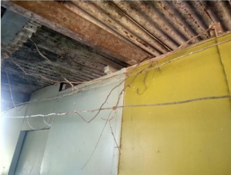
Figura 4 – Instalações Elétricas improvisadas e com fios expostos
