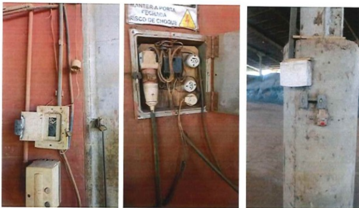
Vários locais com painéis abertos, sem identificação de componentes e disjuntores expostos, expondo os trabalhadores a risco de choque elétrico
