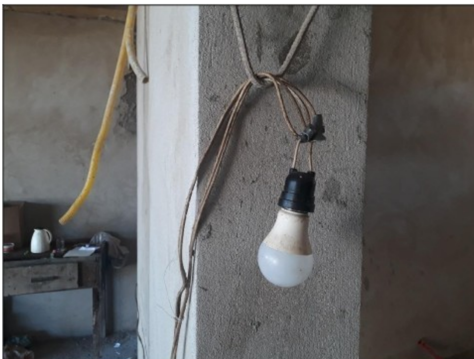
Fotos: Instalações elétricas do local de preparo das refeições.
