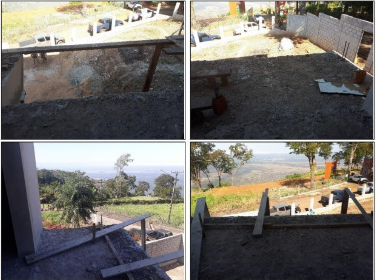
Fotos: Inexistência de proteção contra quedas nas periferias da edificação.
