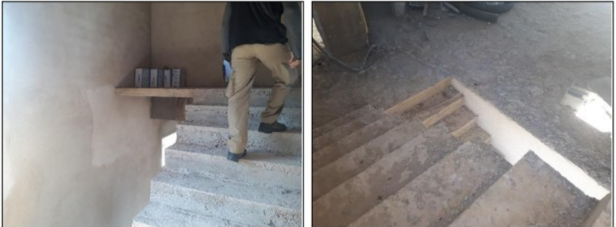
Fotos: Escadas de uso coletivo sem corrimão e sem rodapé.
