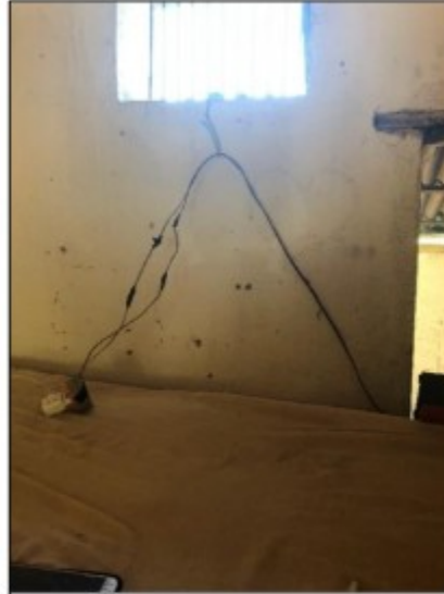
Fotos 1 a 3: instalações elétricas com risco de choque elétrico.
