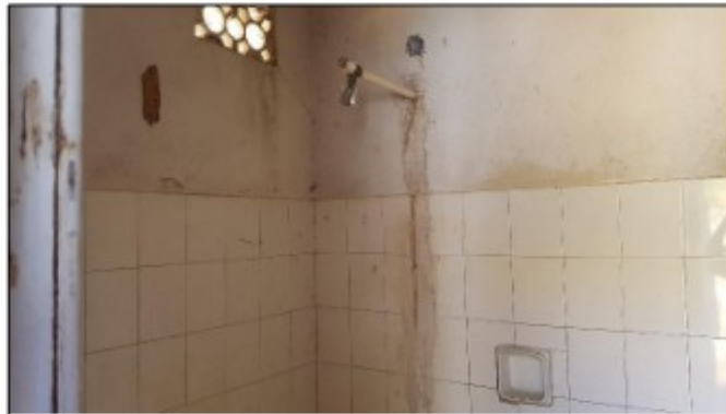
Foto 8: ausência de chuveiro no alojamento (banho com água diretamente do cano).
