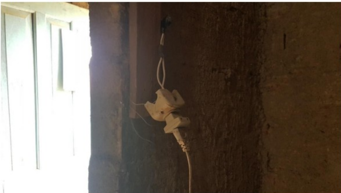
Foto 4: Instalação elétrica improvisada e com partes vivas expostas
