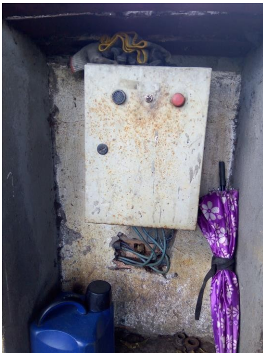
Objetos depositados em local destinado exclusivamente a quadro de energia
