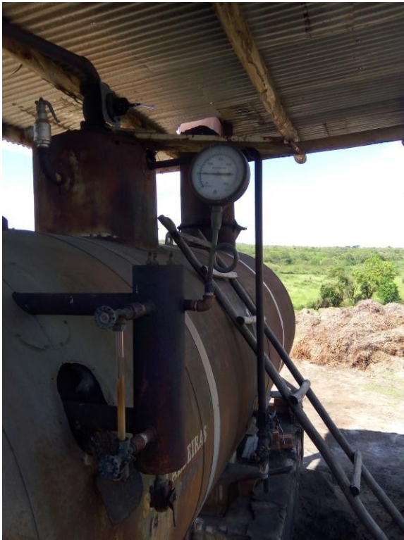
Detalhe da caldeira
