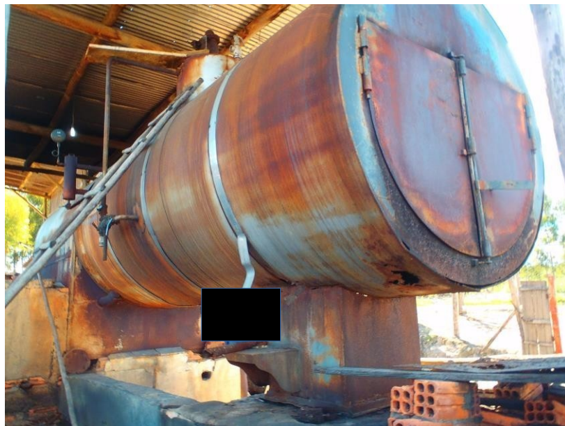
Caldeira vista do piso inferior
