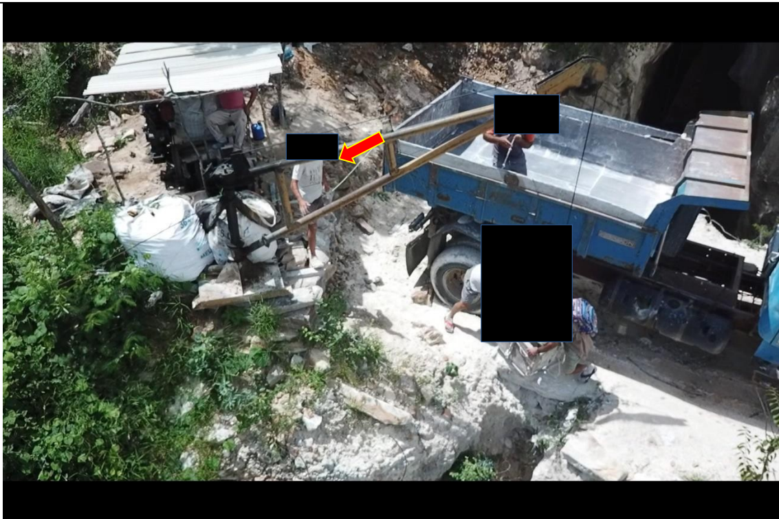
Trabalhadores chegando desembarcando da “cabine” improvisada. Risco de quedas para os passageiros e para o operador que conduz a lança.
