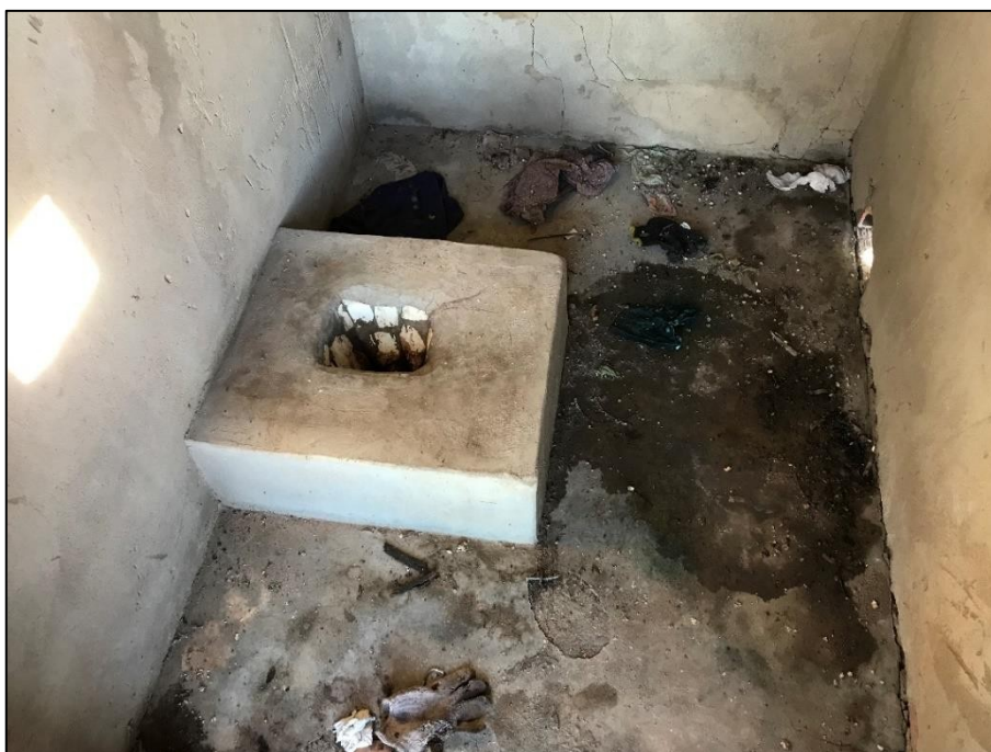
Fotos: Instalações sanitárias da casa de farinha.
