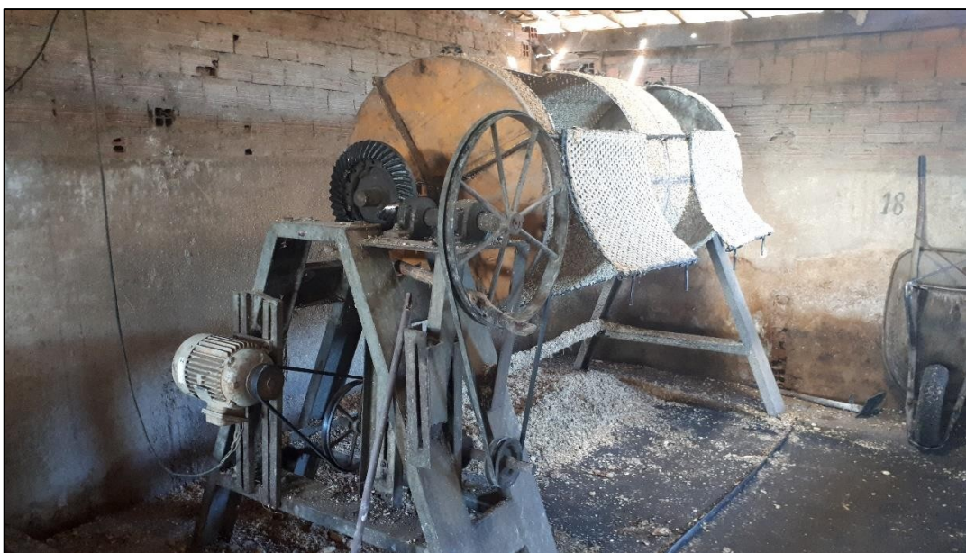
Fotos: Transmissões de força desprotegidas em máquinas da casa de farinha.
