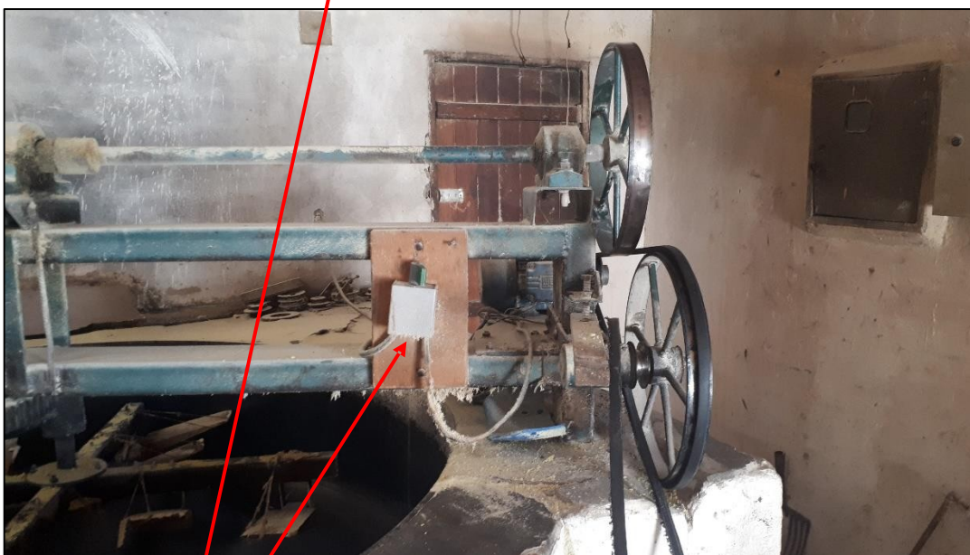
Foto: Dispositivos de acionamento localizados em zonas perigosas dos fornos da casa de farinha.
