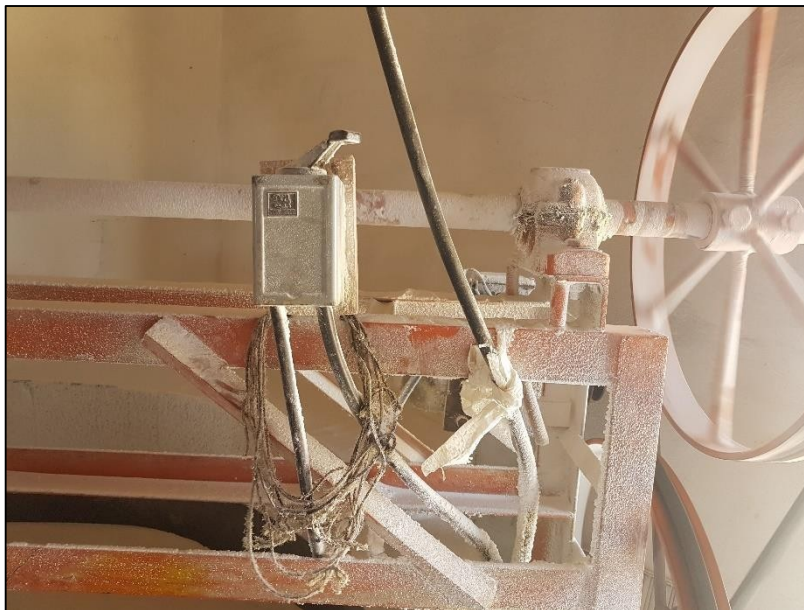
Foto: Dispositivo de acionamento localizado em zona perigosa de um dos fornos da casa de farinha.
