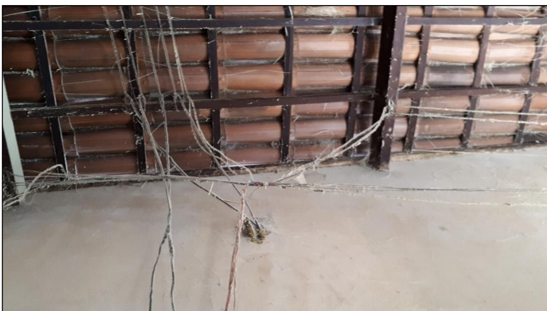
Fotos: Instalações elétricas das casas de farinha.
