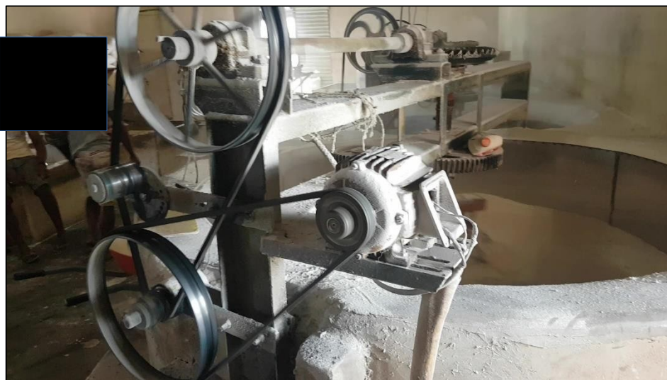
Fotos: Poeira branca sobre as máquinas e sobre o piso. Superior: Casa de Farinha 1. Inferior: Casa de Farinha 2.
