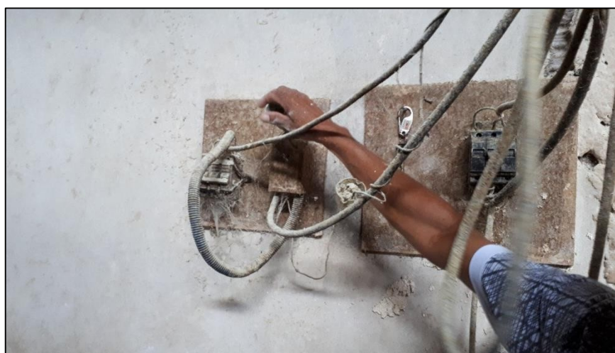
Fotos: Chaves Lombard e disjuntores que eram utilizados para acionar as máquinas das casas de farinha.
