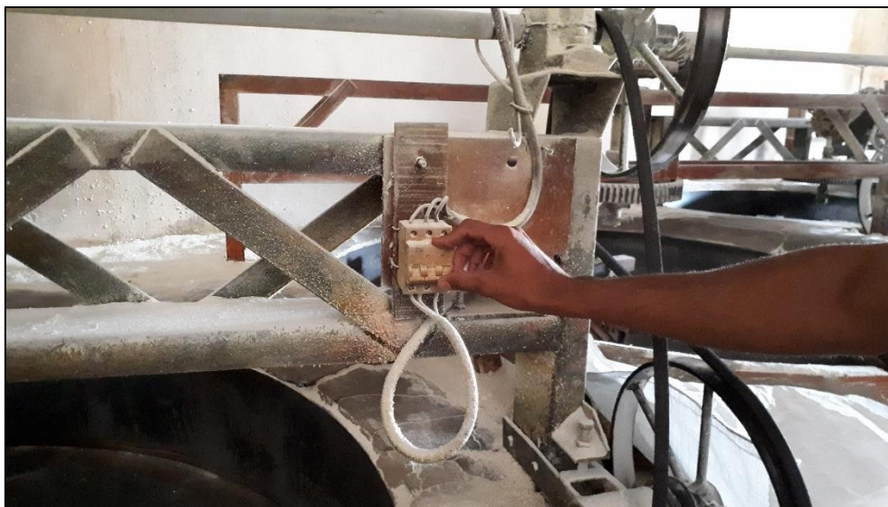
Foto: Dispositivo de acionamento localizado em zona perigosa de máquina da Casa de Farinha I.
