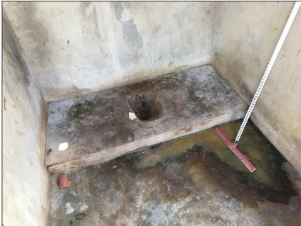
Fotos: Instalações sanitárias da casa de farinha.
