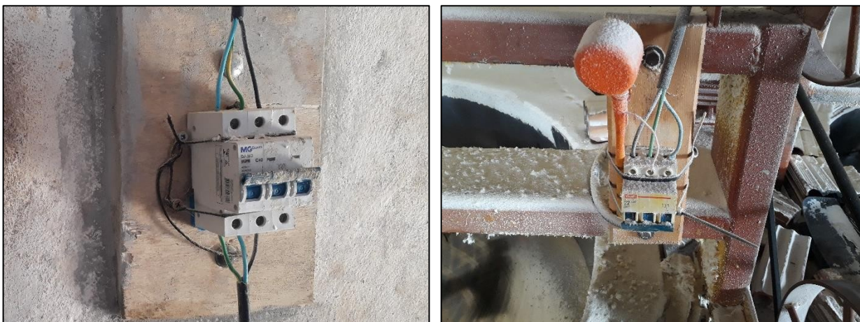
Fotos: Disjuntores que eram utilizados para acionar a prensa (à direita) e um dos fornos (à esquerda) da casa de farinha.
