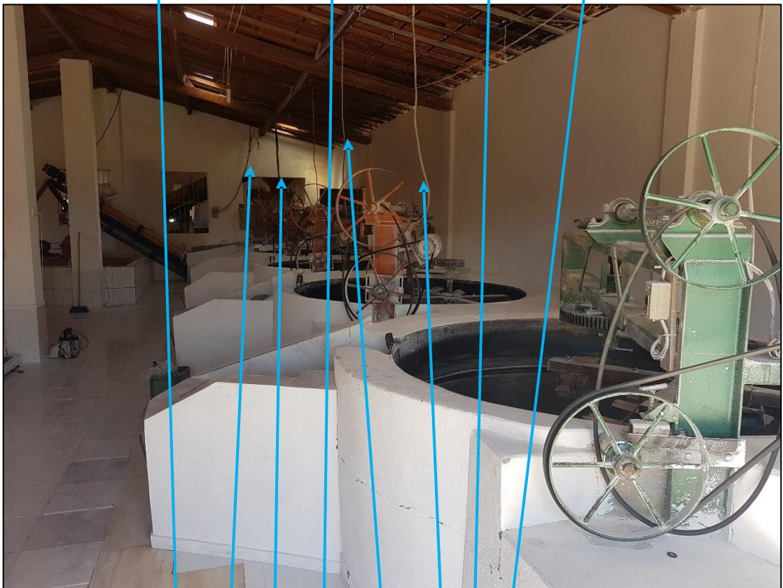
Fotos: Instalações descendo pelo telhado da casa de farinha e alimentando diretamente as máquinas.
