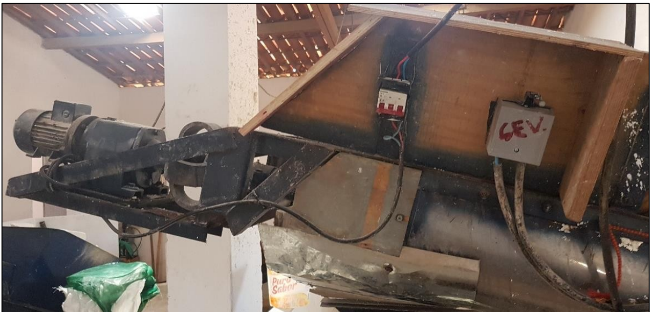
Foto: Disjuntor que era utilizado para acionar e desligar o transportador de rosca sem fim.
