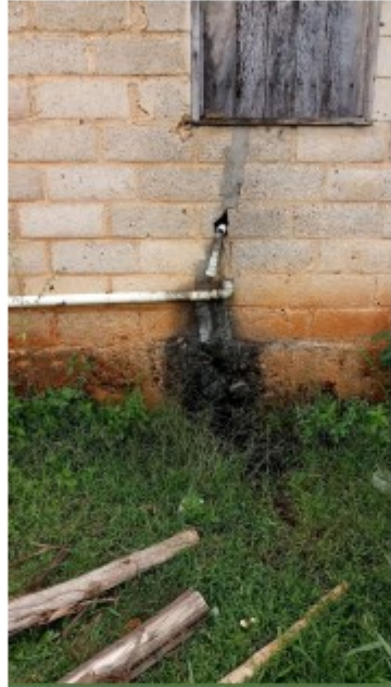
Ligação hidráulica avariada
