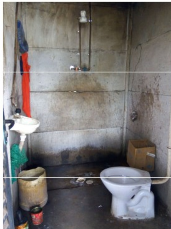
Instalações sanitárias do alojamento 1
