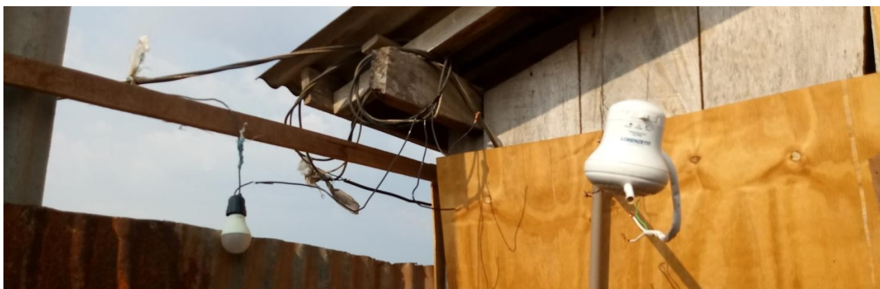
LIGAÇÃO ELÉTRICA IMPROVISADA DO CHUVEIRO - RISCO DE CHOQUE ELÉTRICO
