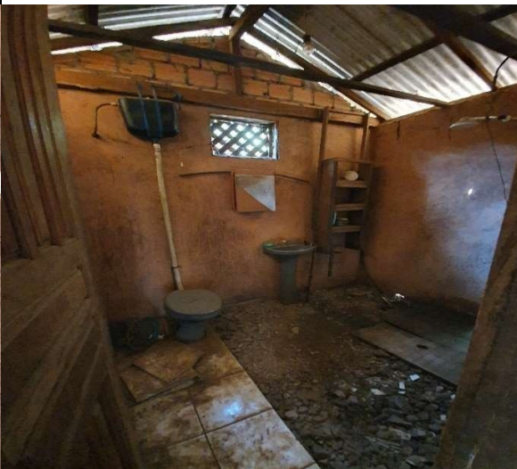
Figura 6: instalação sanitária sem condições de uso
