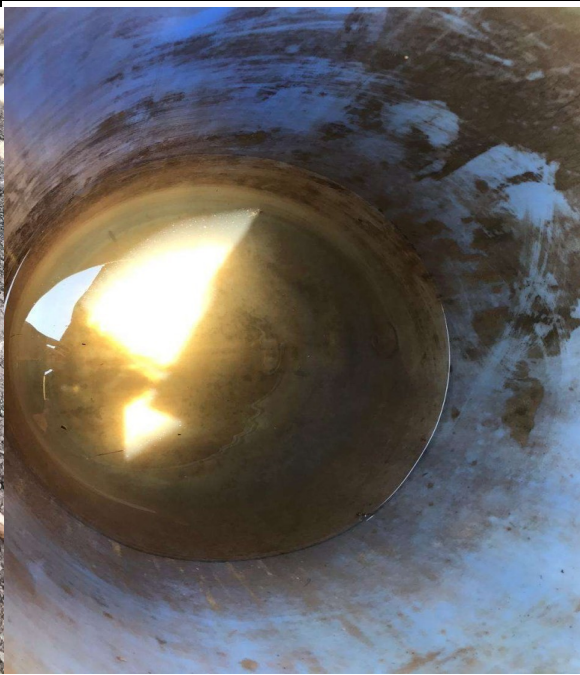
Figura 4: água para consumo armazenada em condições inadequadas
