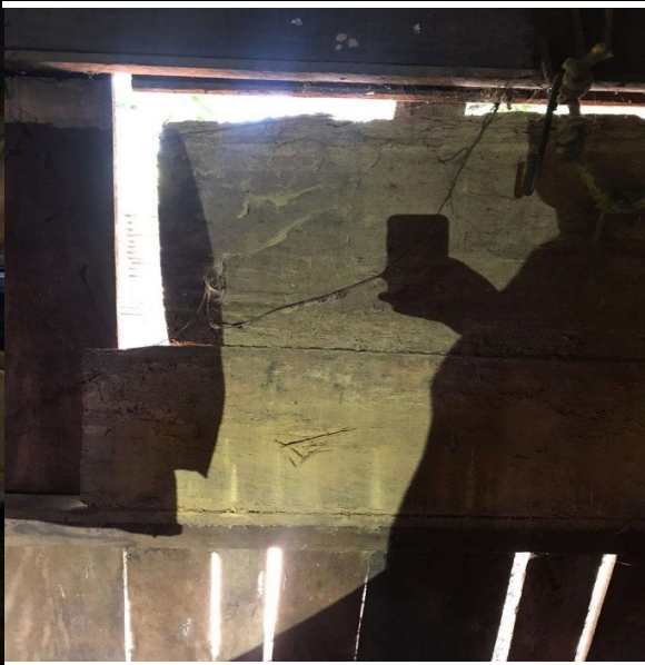
Figura 8: local de pernoite dos trabalhadores (ausência de condições adequadas de vedação)
