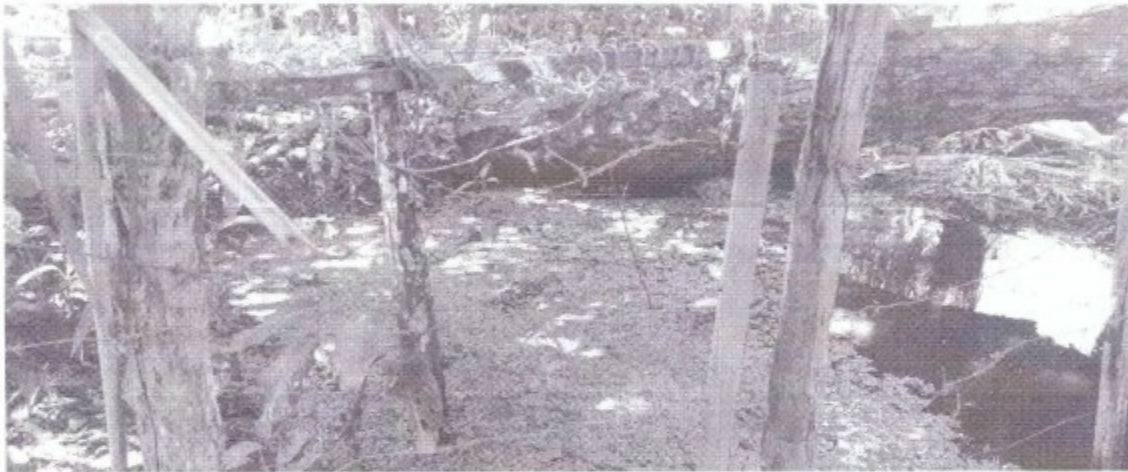
Foto 01 – local de onde é captada a água que abastece a moradia do vaqueiro. Há um poço cacimbão, totalmente encoberto. Presença de folhas, troncos de árvores e algas superficiais.
