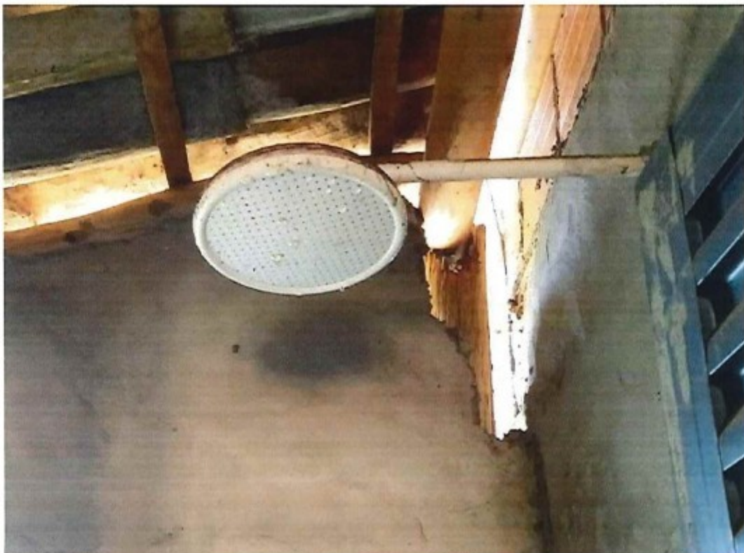
Chuveiro não conectado a rede de energia elétrica
