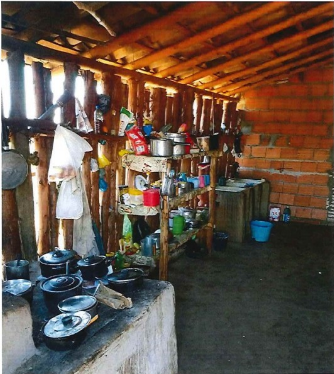
Cozinha - fechamento inadequado e sem armários
