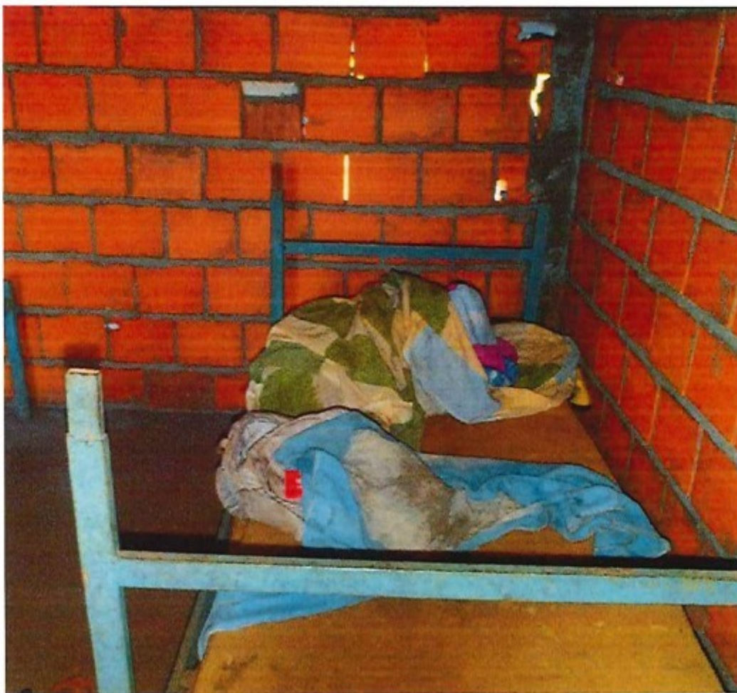
Quarto do trabalhador solteiro – frestas nas paredes
