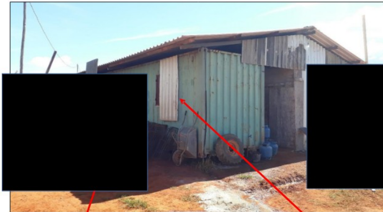
Foto: Havia apenas duas janelas no contêiner, contudo, uma delas não podia ser aberta por estar lacrada com chapa de metal.
