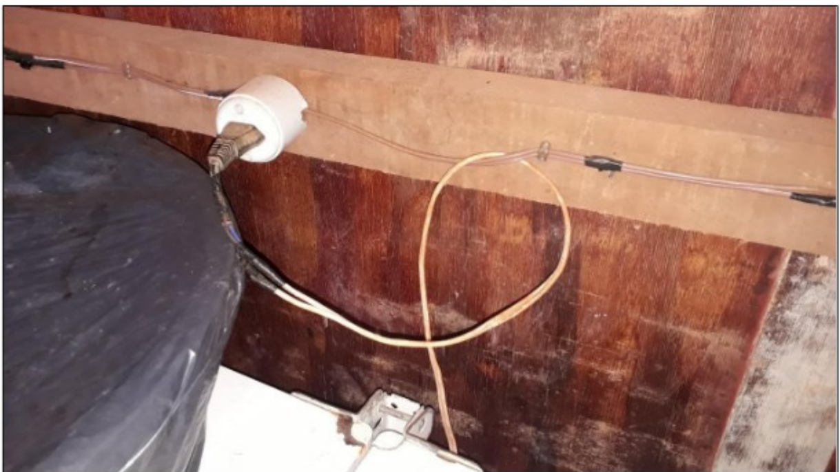
Fotos: Instalações elétricas do local de preparo dos alimentos.
