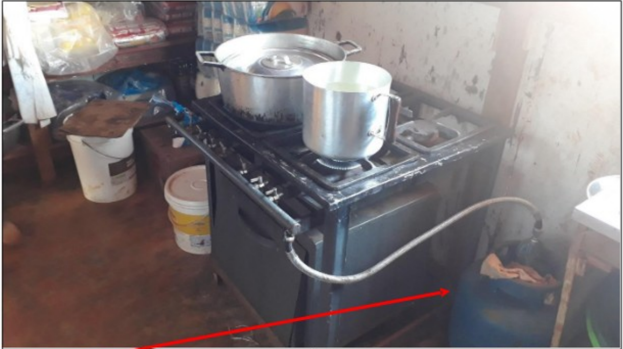
Foto: Botijão de gás instalado no fogão industrial, dentro da cozinha, que era utilizado para preparo das refeições dos obreiros.
