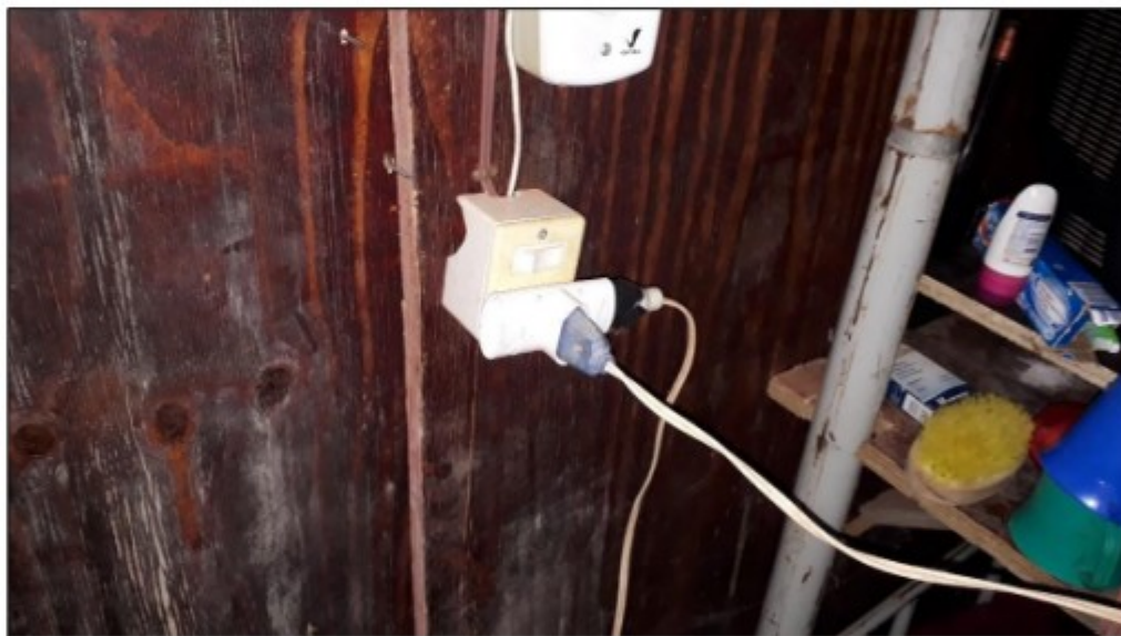
Fotos: Fiações elétricas encontradas no interior do contêiner. Os riscos de choques eram iminentes.
