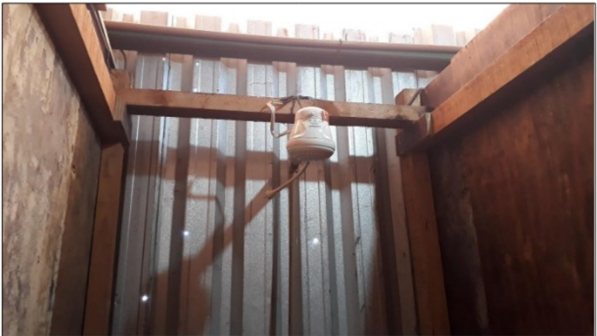
Foto: Instalações elétricas de um dos chuveiros que eram utilizados pelos trabalhadores.
