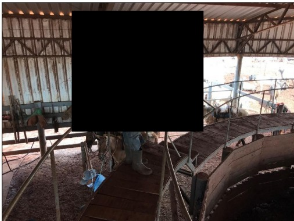
Foto: Plataforma de trabalho do curral, sem proteção total contra risco de queda.
