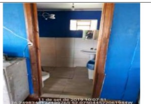
Instalações sanitárias no local de refeições
