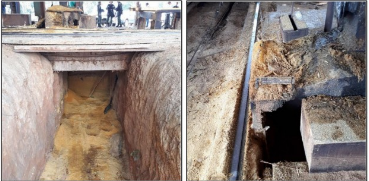
Fotos: Risco de queda em pontos sem proteção no interior da Madeireira.
