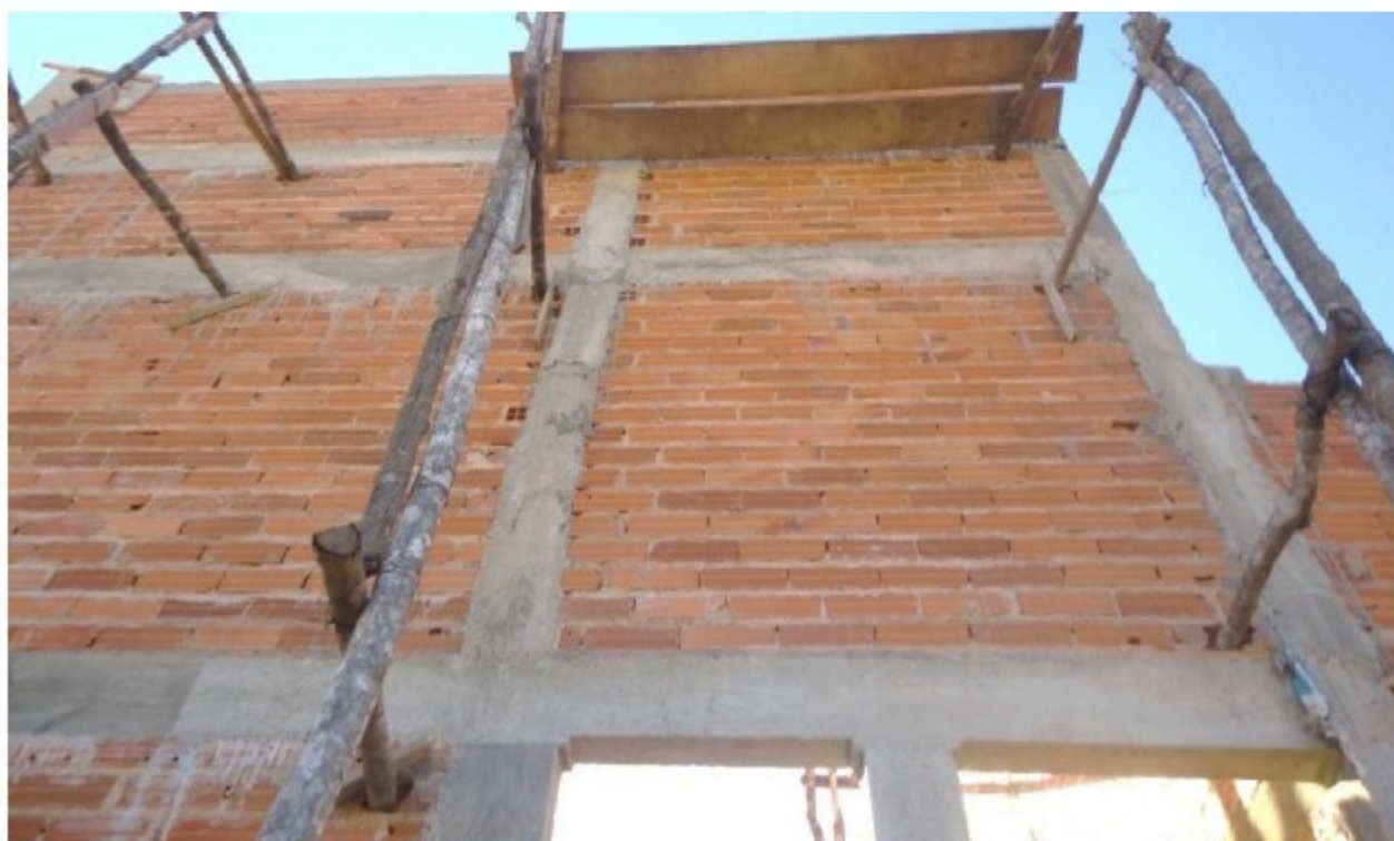
Foto 21 – Andaimen improvisados de madeira roliça, com inúmeras irregularidades, como, p.ex. sem forração completa do piso de trabalho.
