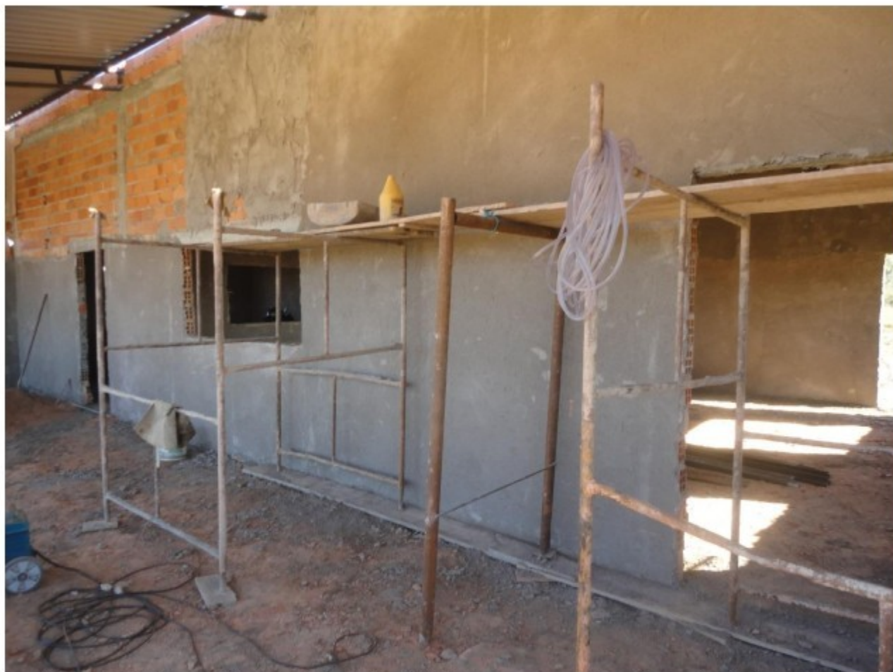
Foto 22 – Andaimet metálicos, com inúmeras irregularidades, como, p.ex. sem forração completa do piso de trabalho.
