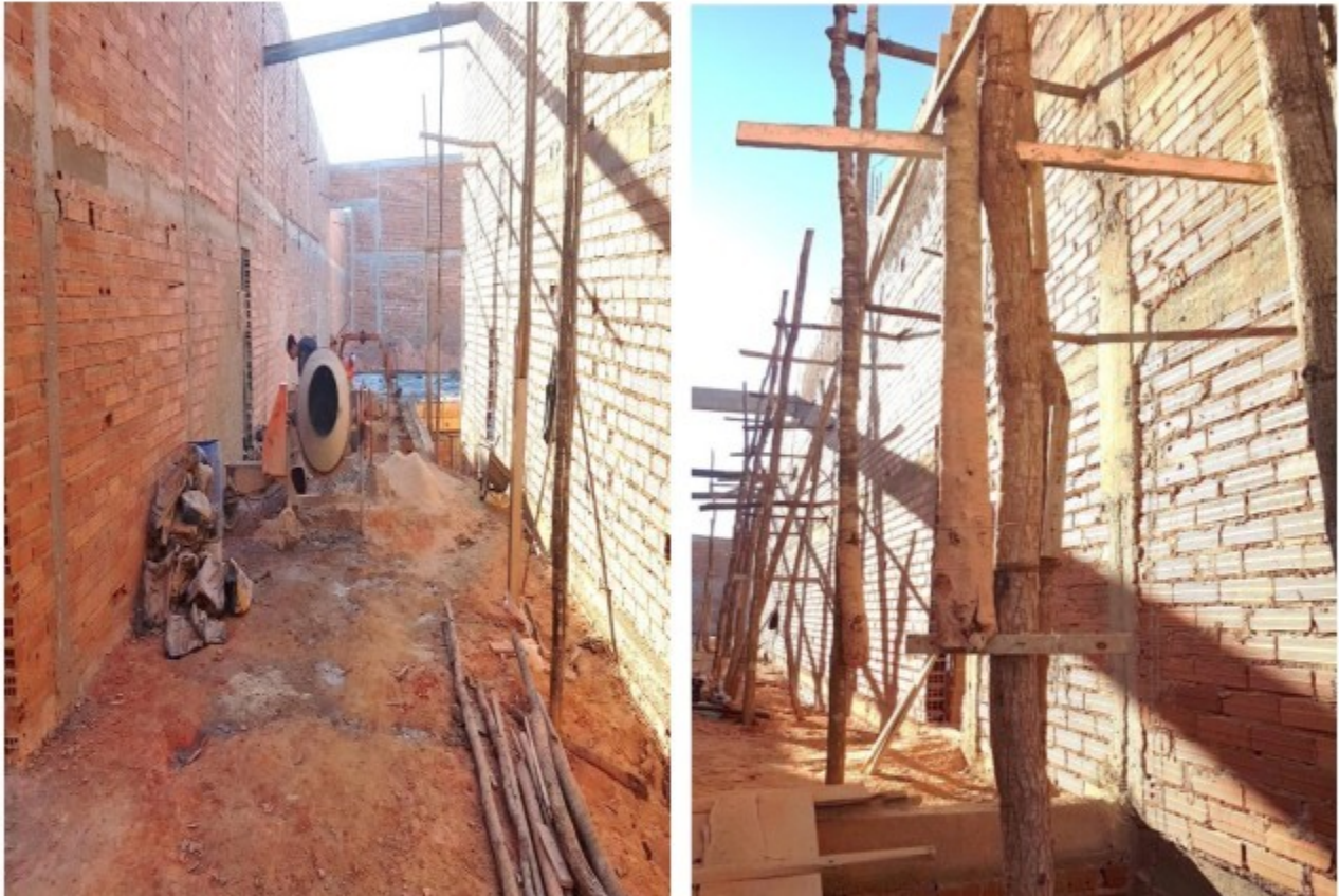
Foto 23 e 24 – Andaimos apoiados no solo em desacordo com as normas de segurança, com riscos de causar acidentes.
