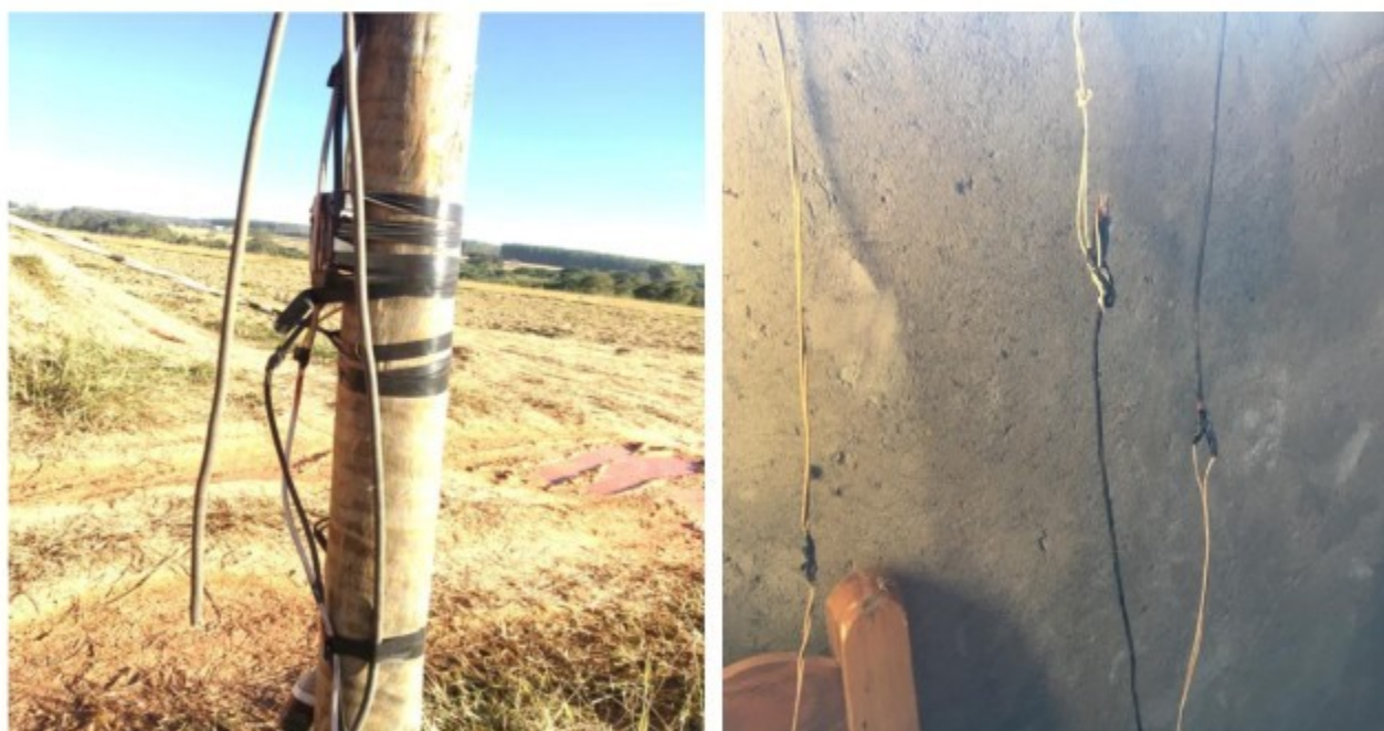
Fotos 43 e 44 – Instalações elétricas improvisadas, com gambiarras, com riscos de choques elétricos.
