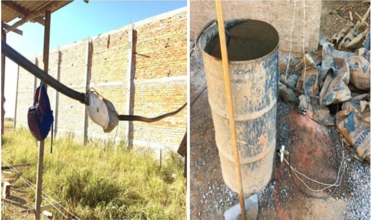
Fotos 45 e 46 – Instalações elétricas improvisadas, com gambiarras, com riscos de choques elétricos.
