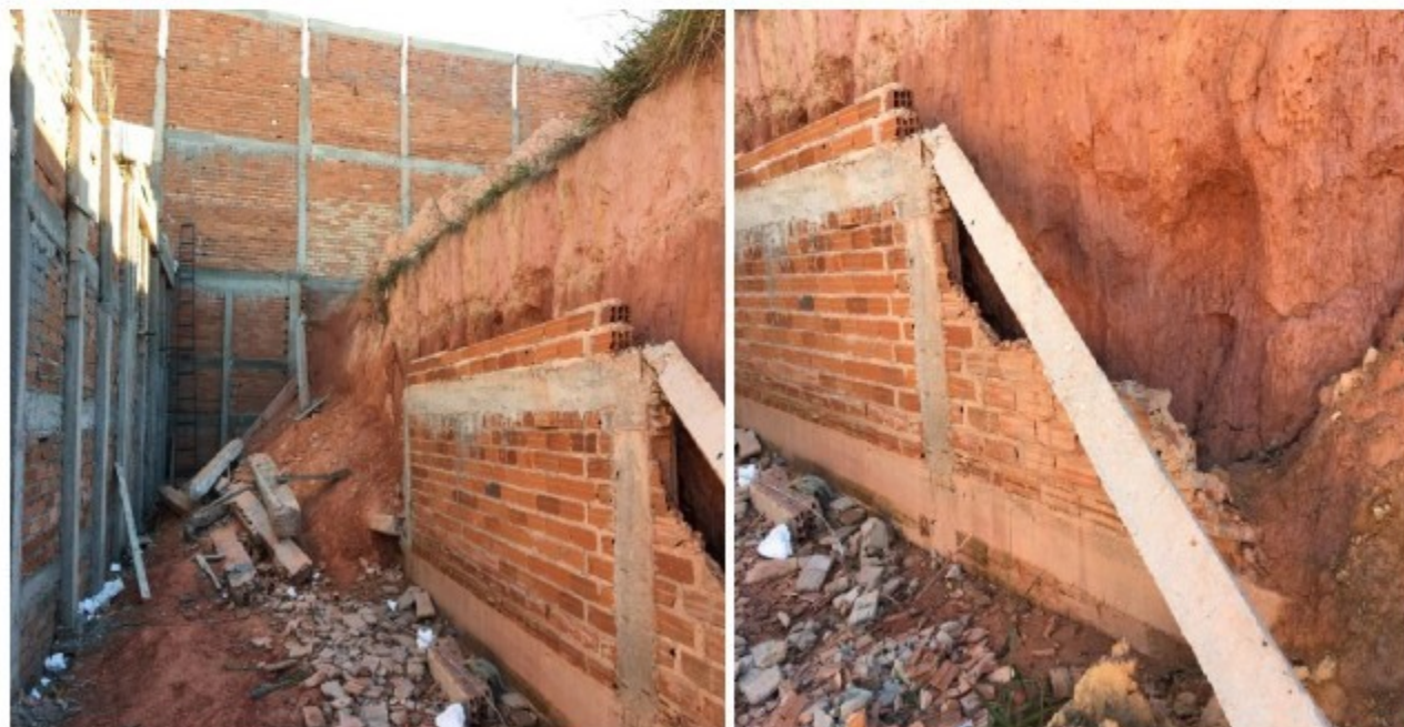
Foto 25 e 26 – Taludes com mais de 1,75m (com cerca de 4m de altura), sem escoramento ou qualquer outra forma de contenção, com sérios riscos de desabamento do solo e soterramento do trabalhador.
