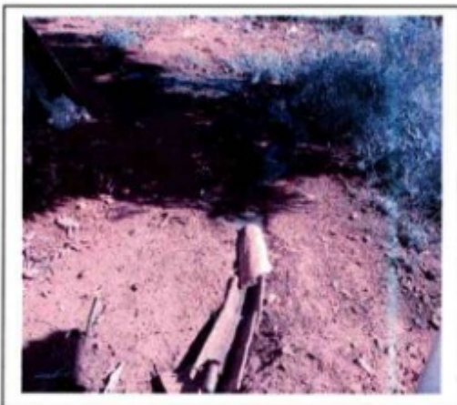
Esgoto a céu aberto na cozinha.
