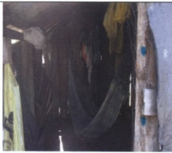
Foto: Interior do barraco. Chão de terra. Vedação insuficiente. Sujidade acentuada.
