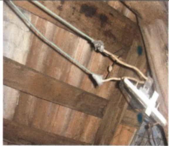
Foto: Derivações elétricas improvisadas, com partes vivas expostas. Alto risco de incêndio.
