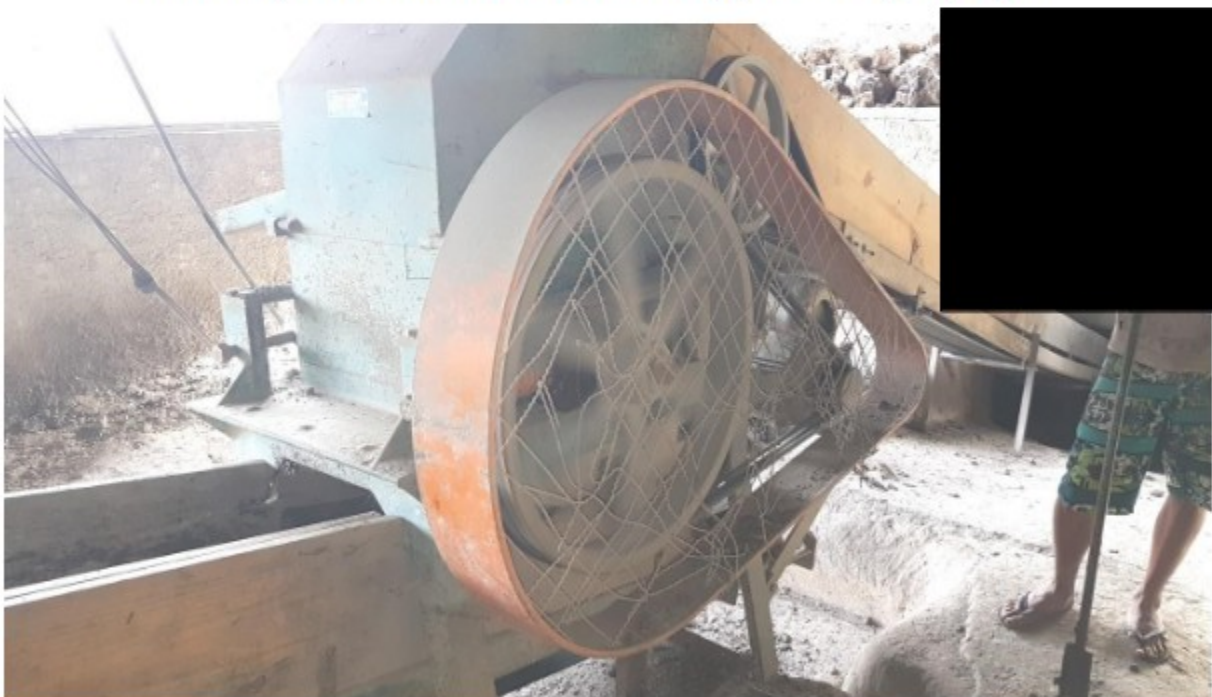
Foto 5- Máquina da Cerâmica Prado: proteção das transmissões de força (polias e correis) com transmissão de força construída de forma inadequada (com grandes aberturas) e ainda já danificada.
