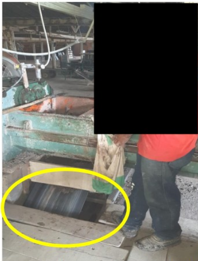
Foto 8 – Calda de um transportador contínuo de materiais sem nenhum sistema de proteção, localizado próximo aos pés do operador de maromba, com sérios riscos de causar acidentes do trabalho.
