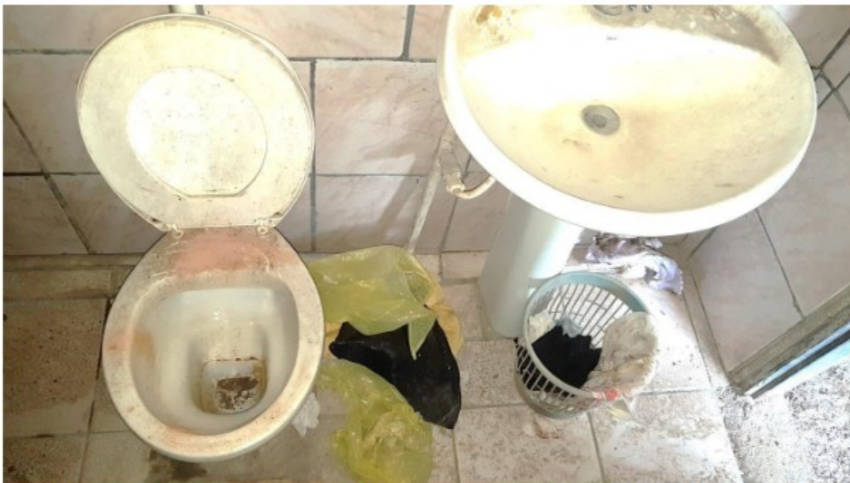
Foto 11– Instalação sanitária da Cerâmica Prado: ausência de limpeza e falta de material para higiene pessoal.
