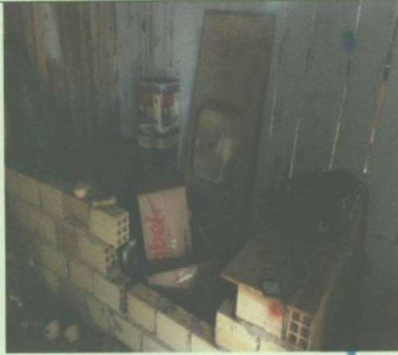
Foto: Em razão da falta de banheiro disponível, os trabalhadores iniciaram eles mesmos a construção de um banheiro dentro do cômodo de madeira onde dormiam.
