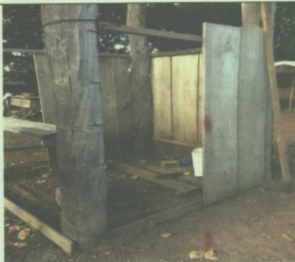
Foto: Improvisação usada como banheiro pelos trabalhadores da serraria
