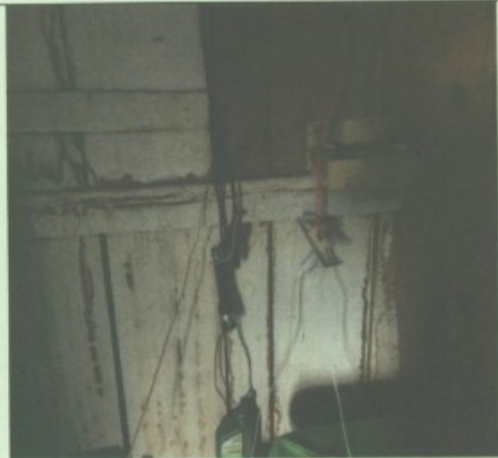
Foto: Fiação elétrica irregular no "puxadinho" da serraria - estrutura de madeira - alto risco de incêndio
