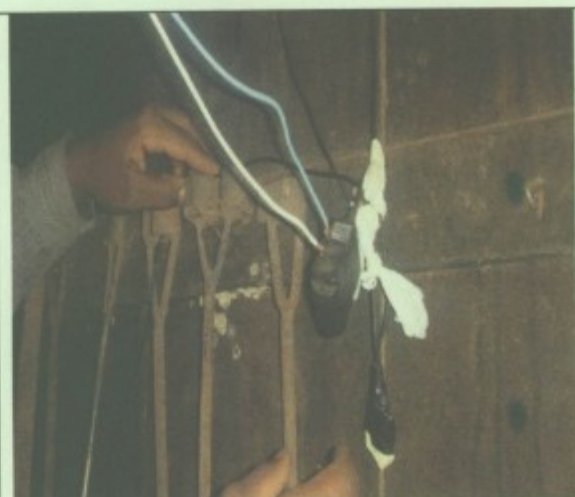
Foto: Fiação elétrica irregular na baia de equinos - estrutura de madeira - alto risco de incêndio
