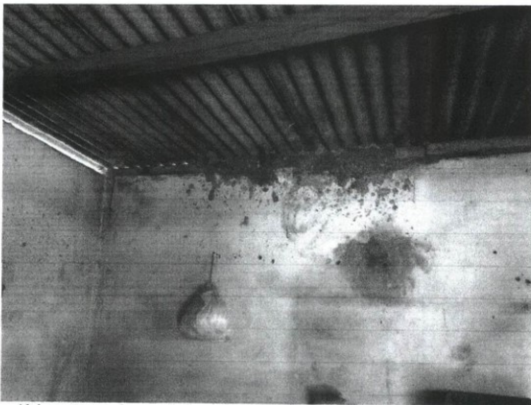
Alojamento: paredes em péssimo estado de conservação e ausência de energia elétrica
