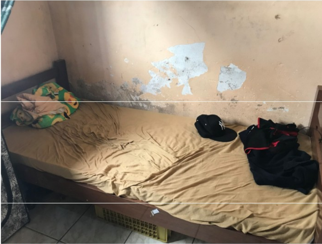
28-03-2018. [REDACTED] Cama improvisada. Panos amontoados improvisam travesseiro. Umidade na parede.
