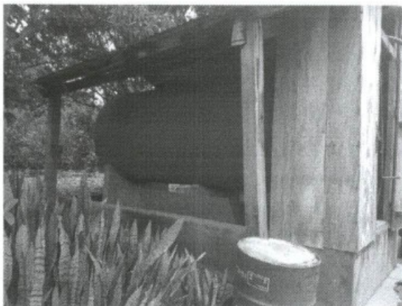
Foto 12: Tanque de óleo diesel
