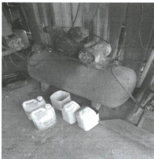
Foto 07: Compressor de ar em conexão com vaso pressurizado
