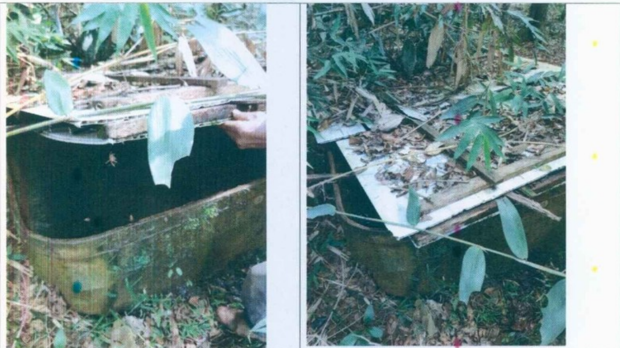
Caixa d'água sem proteção contra contaminação
