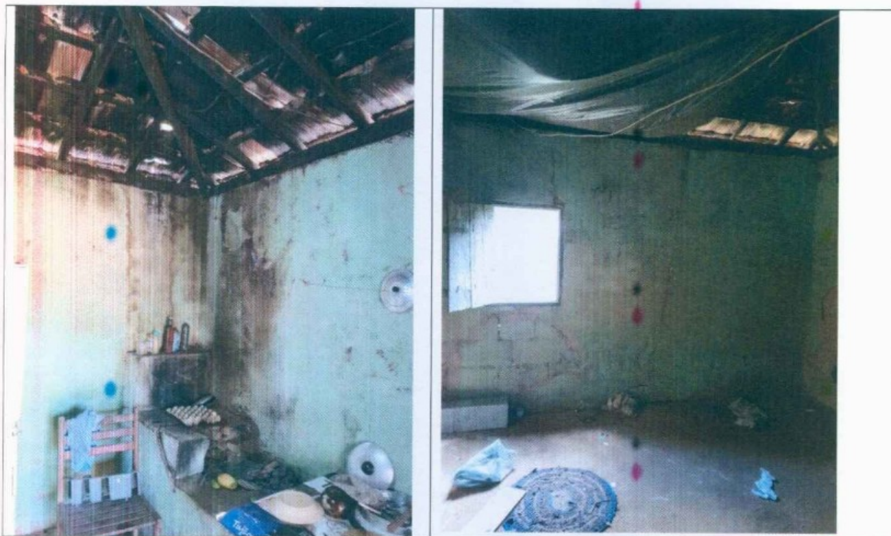
Condições da cobertura da moradia
