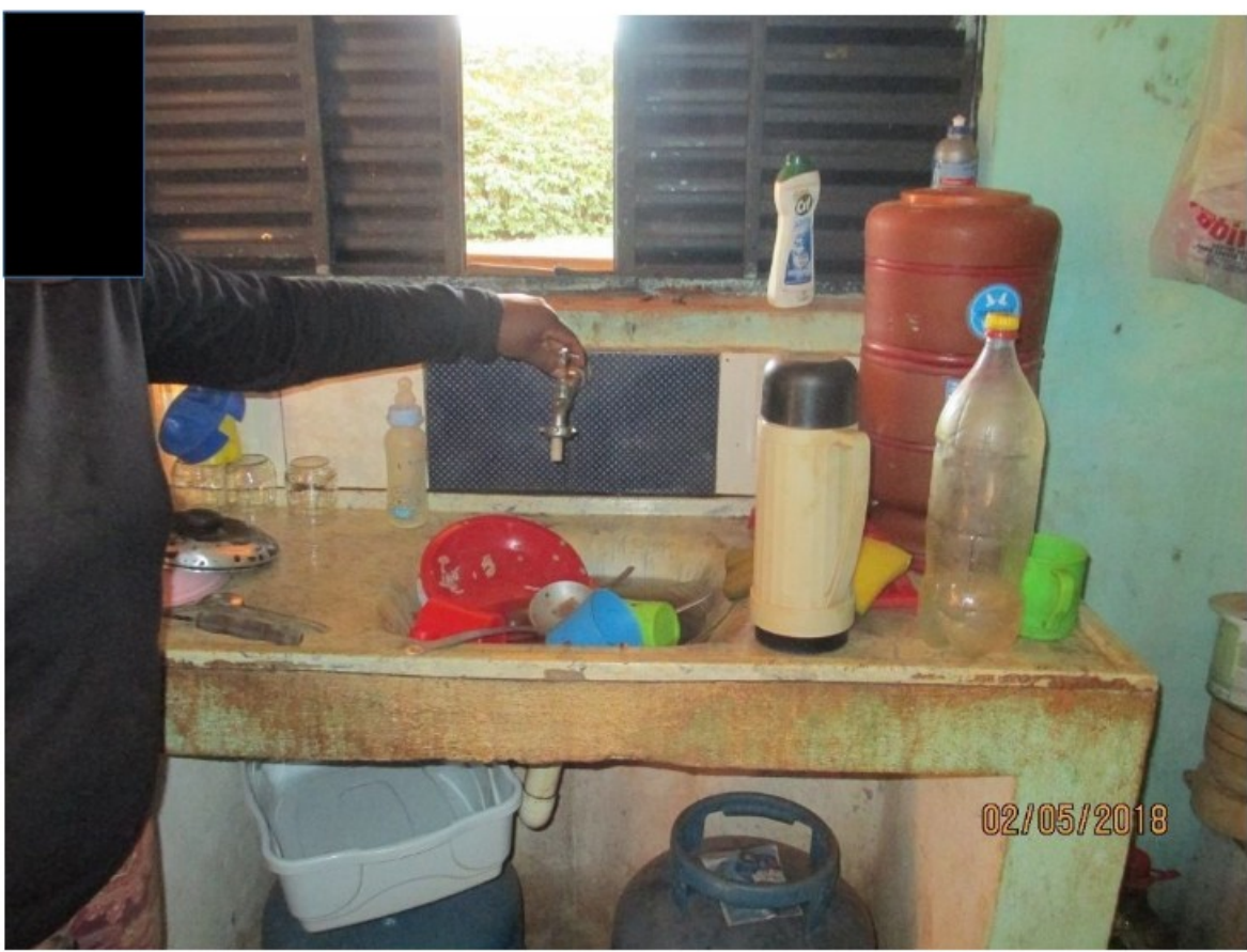
Foto 12 – Pia da cozinha da casa dos trabalhadores, sem água quando da inspeção no local
