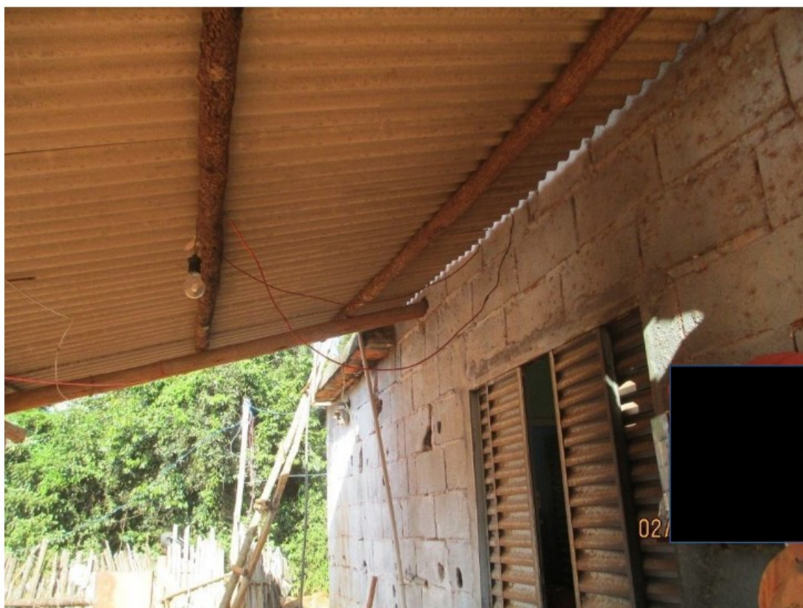
Foto 14 – Instalações elétricas precárias na área externa da moradia trabalhadores rurais
