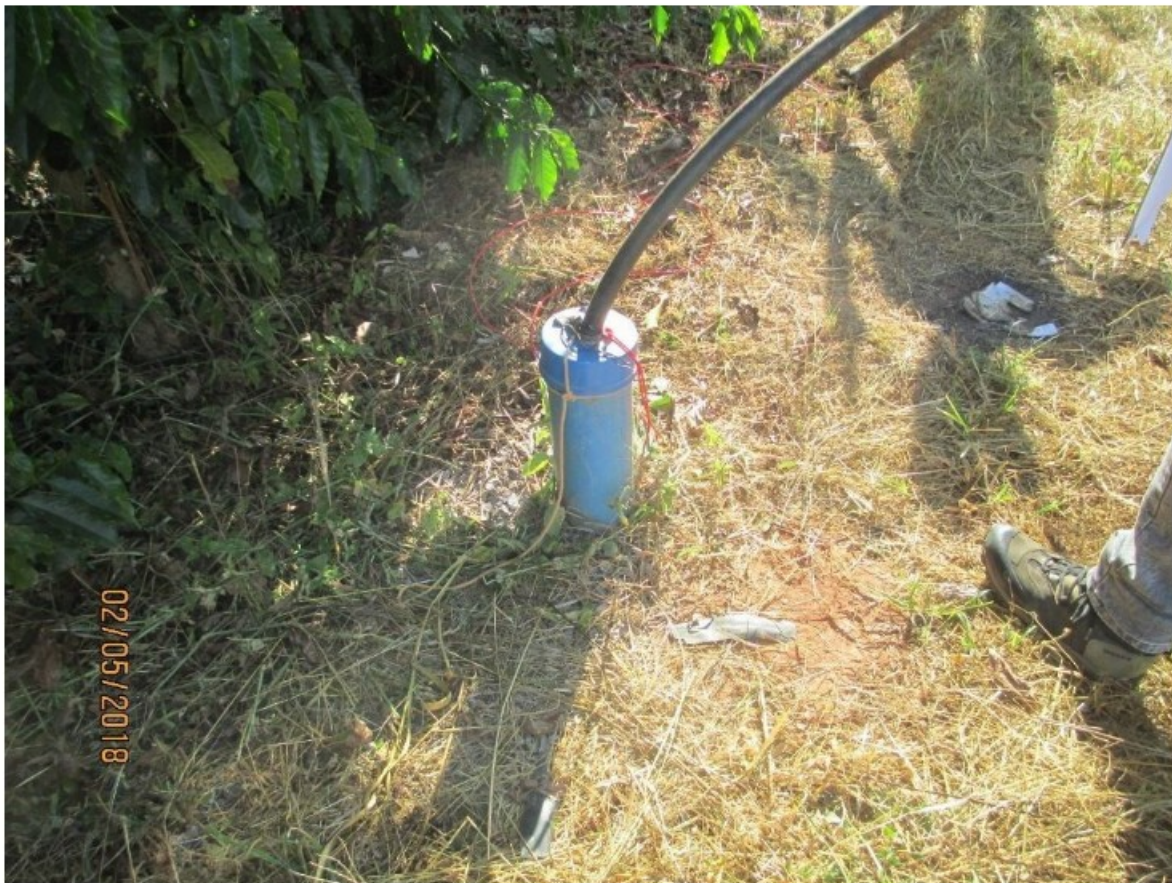
Foto 7 – Poço semi-artesiano instalado no meio do cafezal, com bomba e tubulação acoplada
