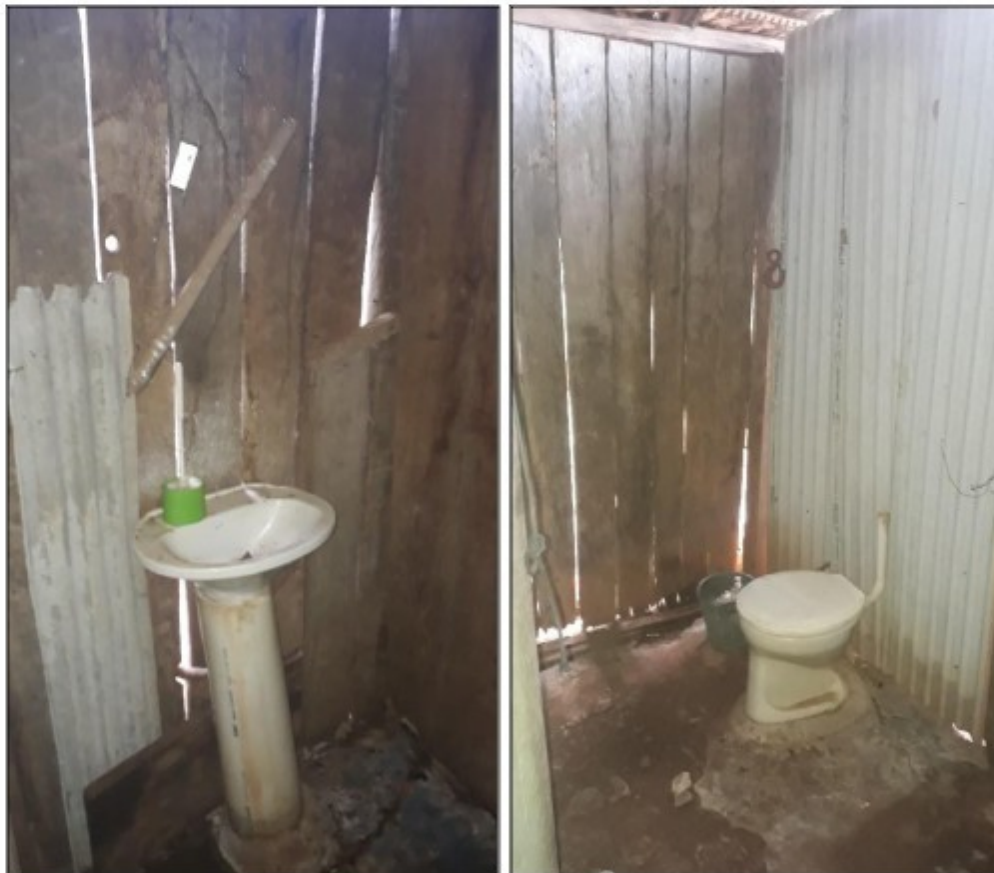
Fotos 11 e 12: instalação sanitária desativada, sem ligações hidráulicas, na medida em que os encanamentos não estavam interligados a uma rede de água e esgoto.
