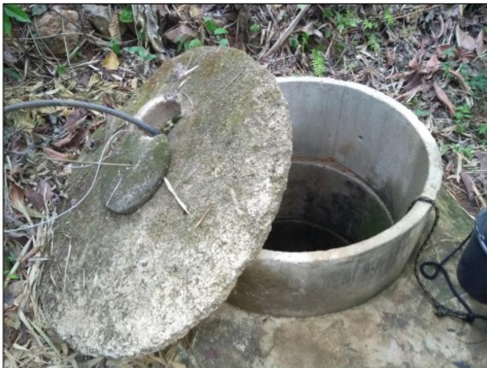
Foto 8: cisterna que ficava com a tampa aberta para facilitar a retirada da água para consumo, já que a bomba estava quebrada.
