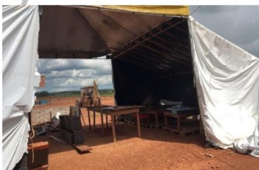
Dormitório e canteiro de obra no mesmo espaço.
