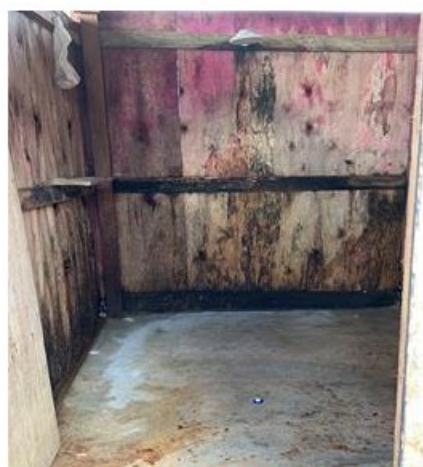
Banheiros com paredes não lavável
