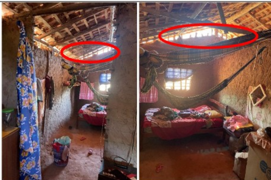
Imagens do quarto de pernoite do trabalhador [REDACTED] esposa e filhos. Na porta e na janela, apenas uma peça de tecido. Nos detalhes, vê-se que as paredes não vedavam até o teto.
