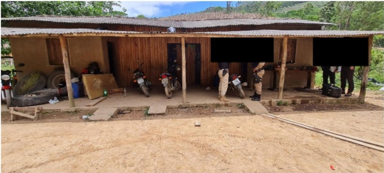
Vista frontal do alojamento, com parte construída em ripas, telhas de amianto e acúmulo de materiais na varanda.
