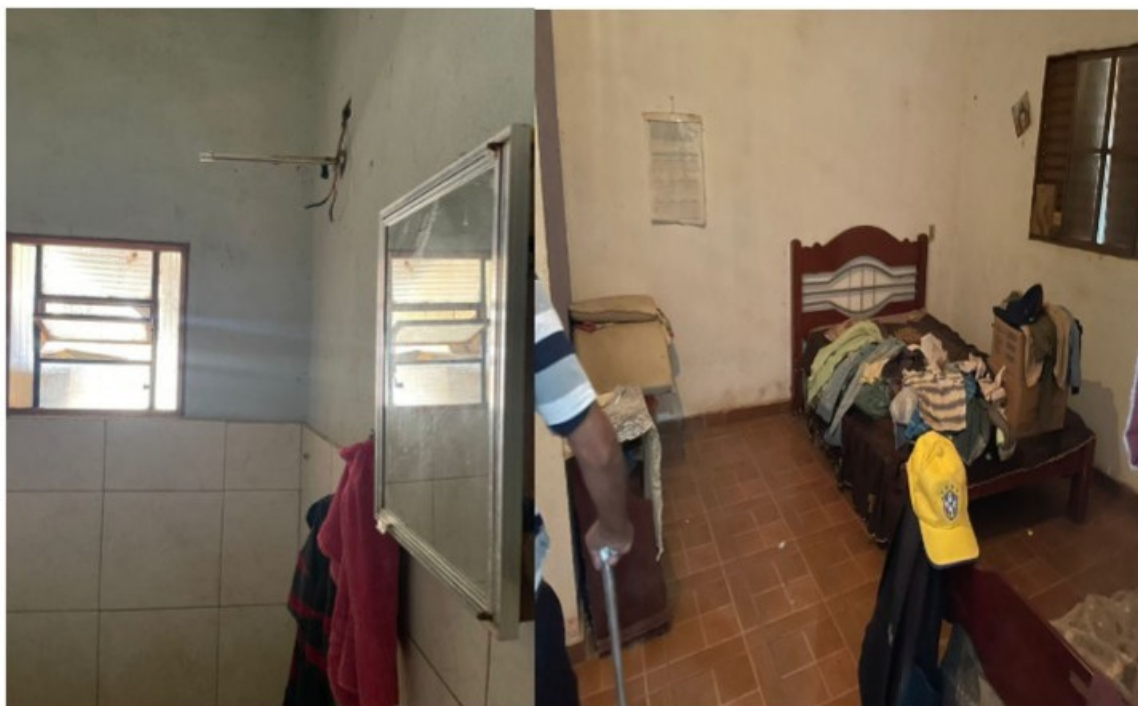
Figura 6: Banheiro sem chuveiro
