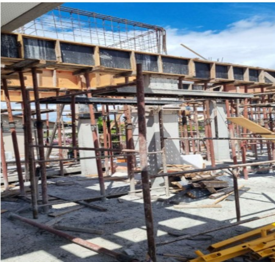
Figura 11: Utilização de andaimes em desacordo com a NR-18.
