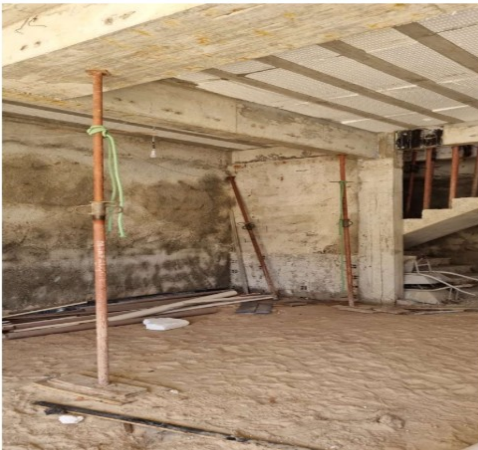
Figura 12: Na garagem, escoras entre as quais o empregado [REDACTED] armava a rede
