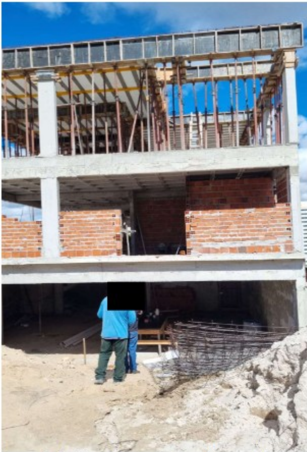
Figura 3: Ausência de proteção coletiva onde houver risco de queda de trabalhadores ou de projeção de materiais ou objetos
