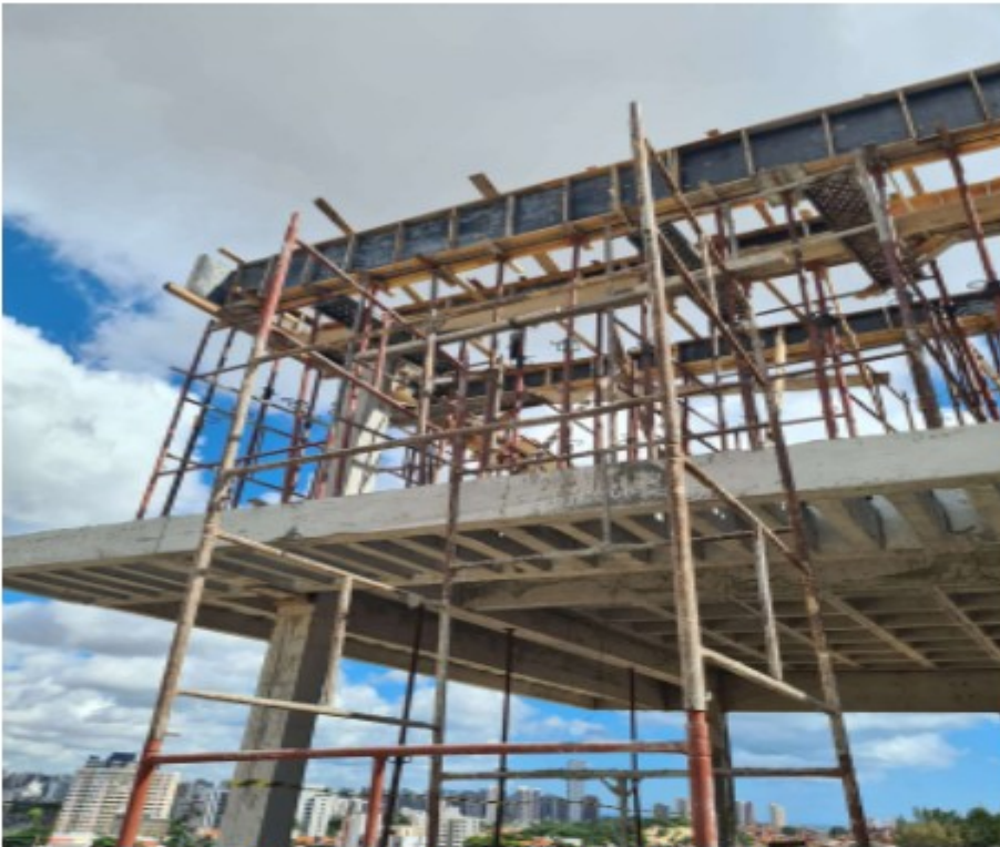
Figura 10: Utilização de andaimes em desacordo com a NR-18.
