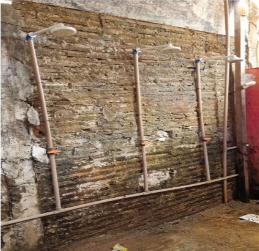
Figura 17: Área destinada ao banho, sem separação em gabinetes e sem paredes ou piso laváveis
