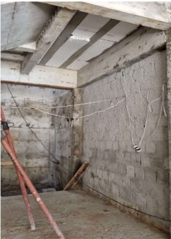
Figura 7: fiação com risco de choque elétrico.
