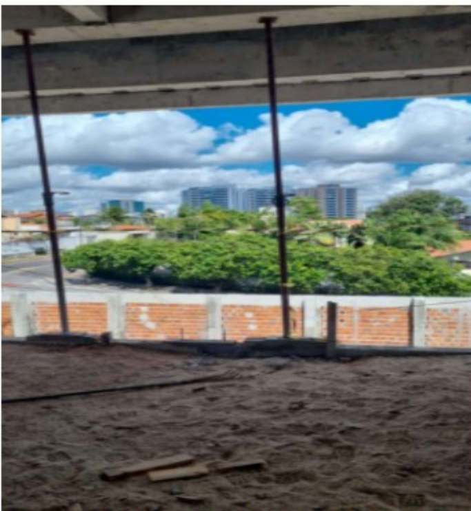
Figura 4: Ausência de proteção coletiva onde houver risco de queda de trabalhadores ou de projeção de materiais ou objetos
