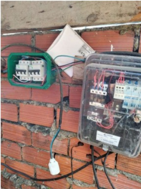
Figura 6: Quadro de distribuição das instalações elétricas em desacordo com o disposto no subitem 18.6.10 da NR 18
