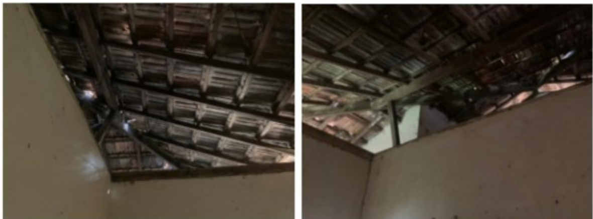
O telhado da casa do trabalhador possuía furos
