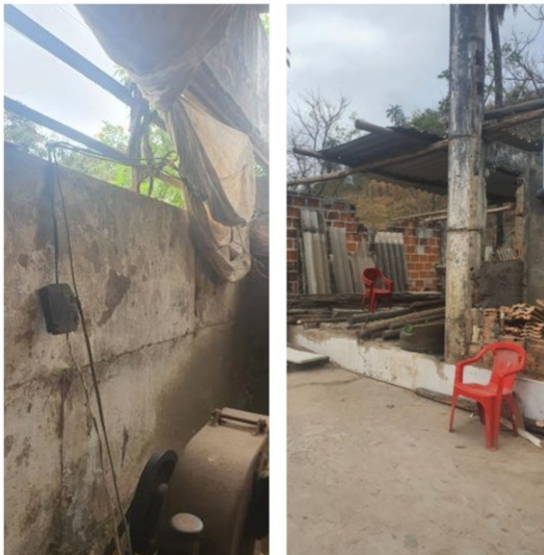
Condições constatadas no galpão
