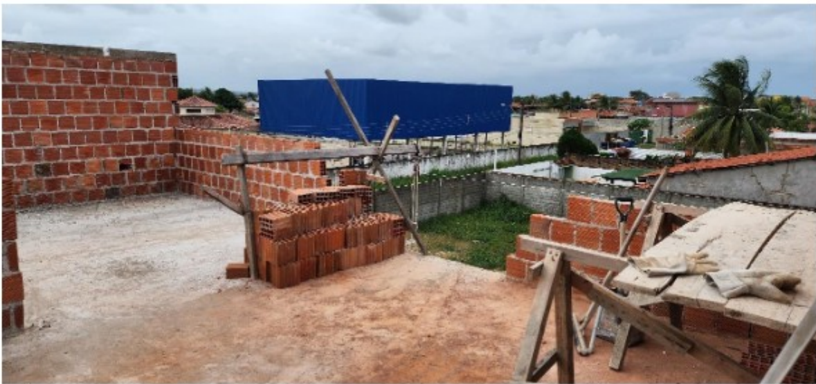
TRABALHO EM ALTURA SEM PROTEÇÃO
