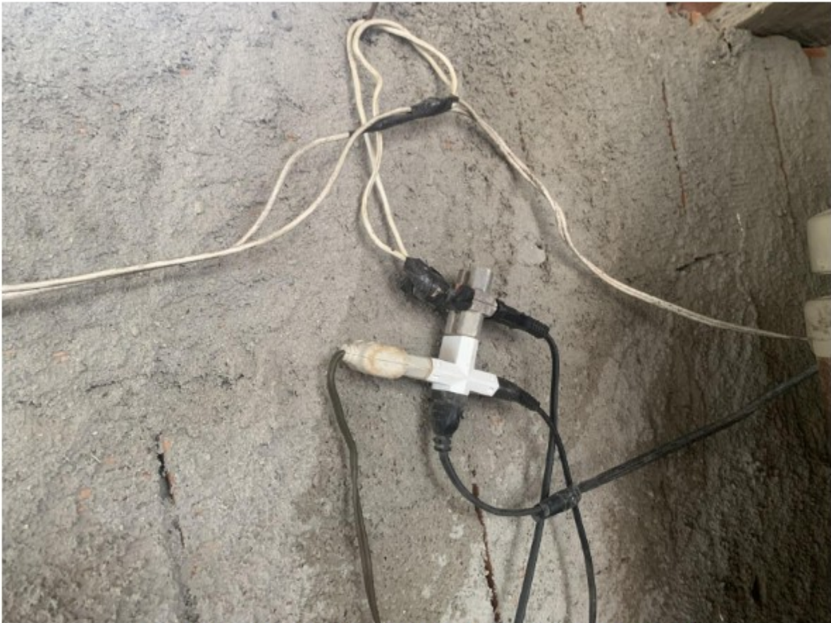
LIGAÇÕES ELÉTRICAS EM DESACORDO COM A NORMA
