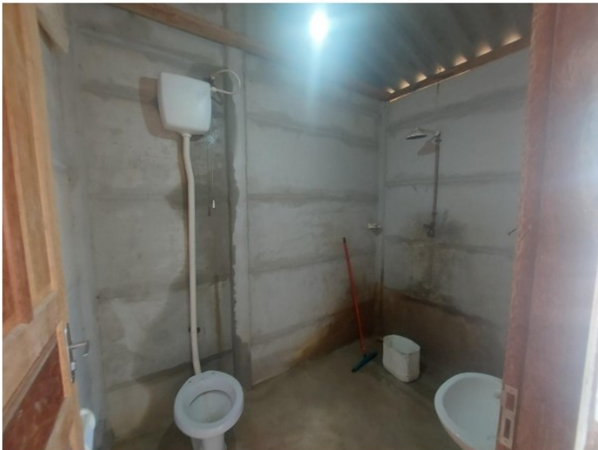
Foto das instalações sanitárias do alojamento. Verifica-se que o vaso sanitário não possui tampo, ausência de mictório e não há entre vaso e chuveiro
