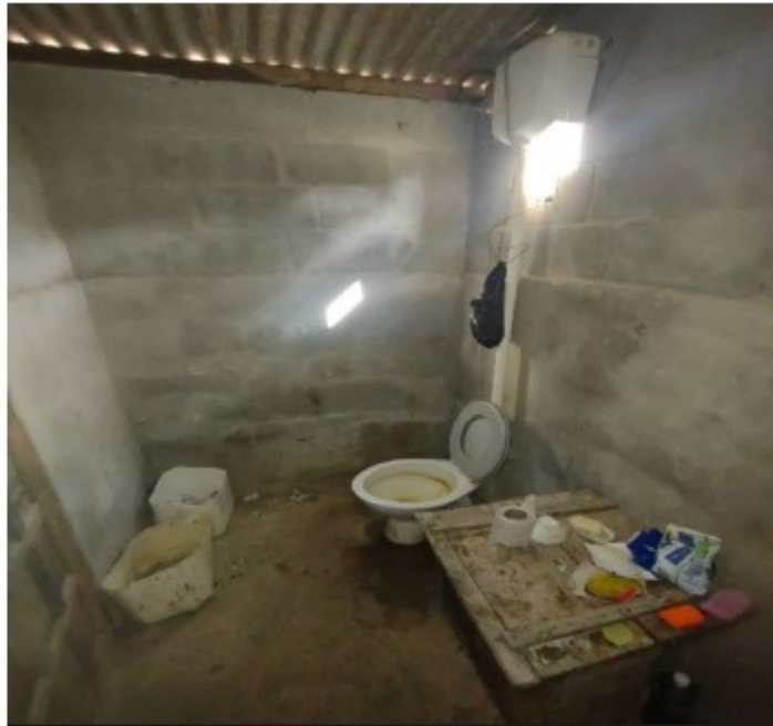
Figura 3 - Banheiro sem vedação contra entrada de animais
