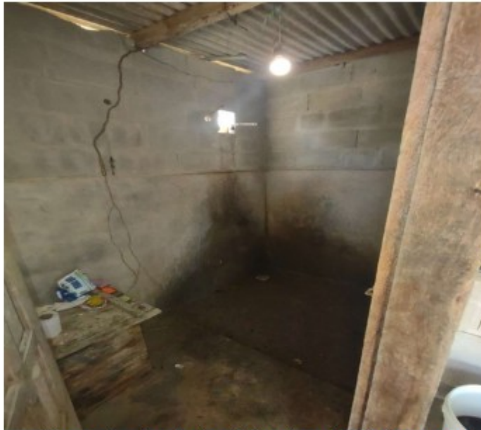
Figura 1 - Banheiro utilizado pelos dois empregados entrevistados, com muito lodo, sem ladrilhos e sem chuveiro
