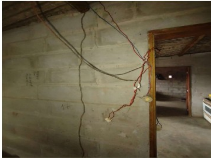
Figura 7 - Instalações elétricas precárias favoreciam acidentes com choques elétricos e incêndios
