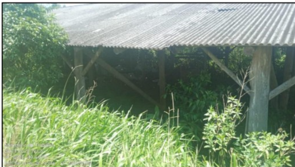
Figura 2 – Vegetação tomando conta do galpão.
