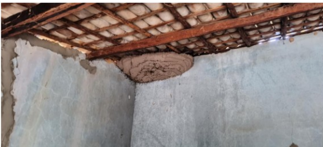
Caixa de marimbondos no interior da edificação utilizada como alojamento
